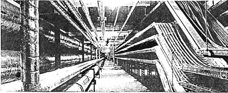
Der 700 Meter lange "Medien-Transport-Verkehrs-Kanal" stellt das Rückgrat der Energieversorgung des neuen Bank- und Verwaltungszentrums am Stuttgarter Hauptbahnhof dar.
