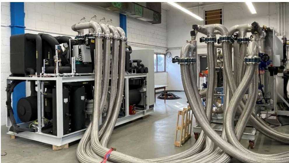
Bild 5: Prüfstand für neuentwickelte Hochtemperaturwärmepumpen (Bildquelle: Combitherm GmbH / Bitzer SE Kälte- und Klimatechnik)
